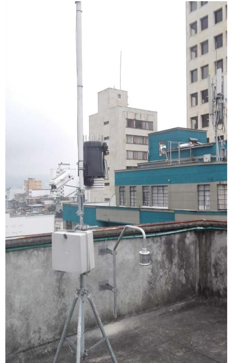
Figura 4. Molino de campo eléctrico instalado en la Gobernación de Caldas
