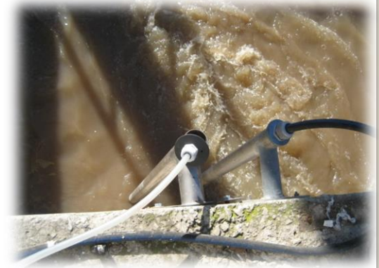
Fallos de los aparatos o problemas con el suministro eléctrico
