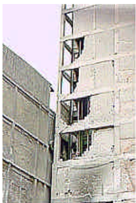
Edificio dañado por golpeteo
