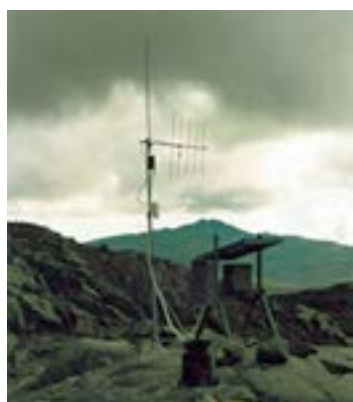
Estación hidrometeorológica quebrada Nereidas PNNN.
