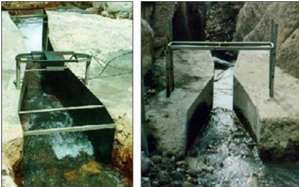
Figura 4. Fotografías que muestran detalles de la canaleta Parshall de la Estación hidrometeorológica quebrada Molinos, PNNN. Fuente: propia
